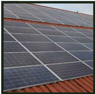
Utilizzo di energie rinnovabili: pannelli fotovoltaici
